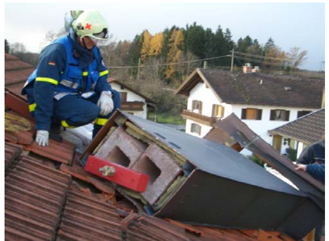
Mit Ankerstab verspannter Kamin nach Windbruch zum Schutz vor Zerbrechen während der Kranbergung (Bild OV BGL)
